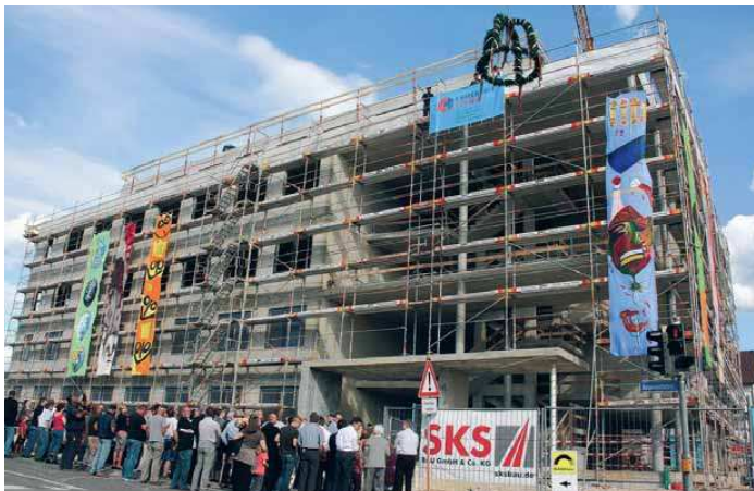
Richtfest an der Neuhauser Straße: Der Rohbau des Tuttlinger Ärztehauses ist fertig.
